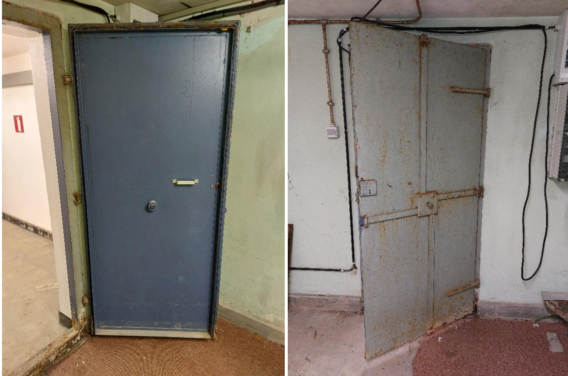
Figuur 10: De twee types van deuren aanwezig in de sas van de schuilplaats (Bron: Monument Vandekerckhove Nv, 2024).
