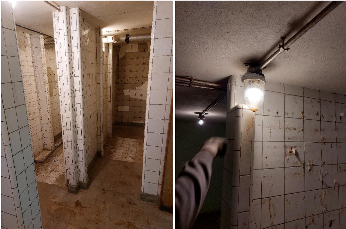
Figuur 8: Douches van de schuilplaats met originele betegeling en originele verlichting (recht) (Bron: Monument Vandekerckhove Nv, 2024)
