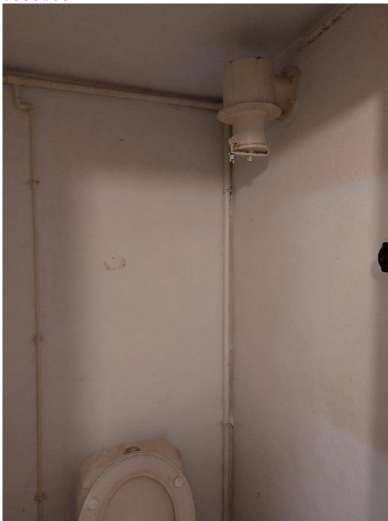
Figuur 5: Oorspronkelijk ventilatiesysteem binnen de WC van de schuilplaats (Bron: Monument Vandekerckhove Nv, 2024).
